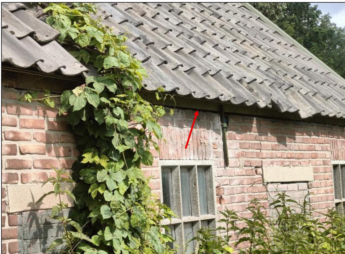
Foto 2: kier in de buitengevel van de schuur waardoor de spouw toegankelijk is voor vleermuizen, aangegeven met de rode pijl.
