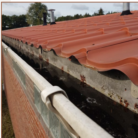
Afbeelding 2: Dak sanitairgebouw ter hoogte van de dakgoot.
