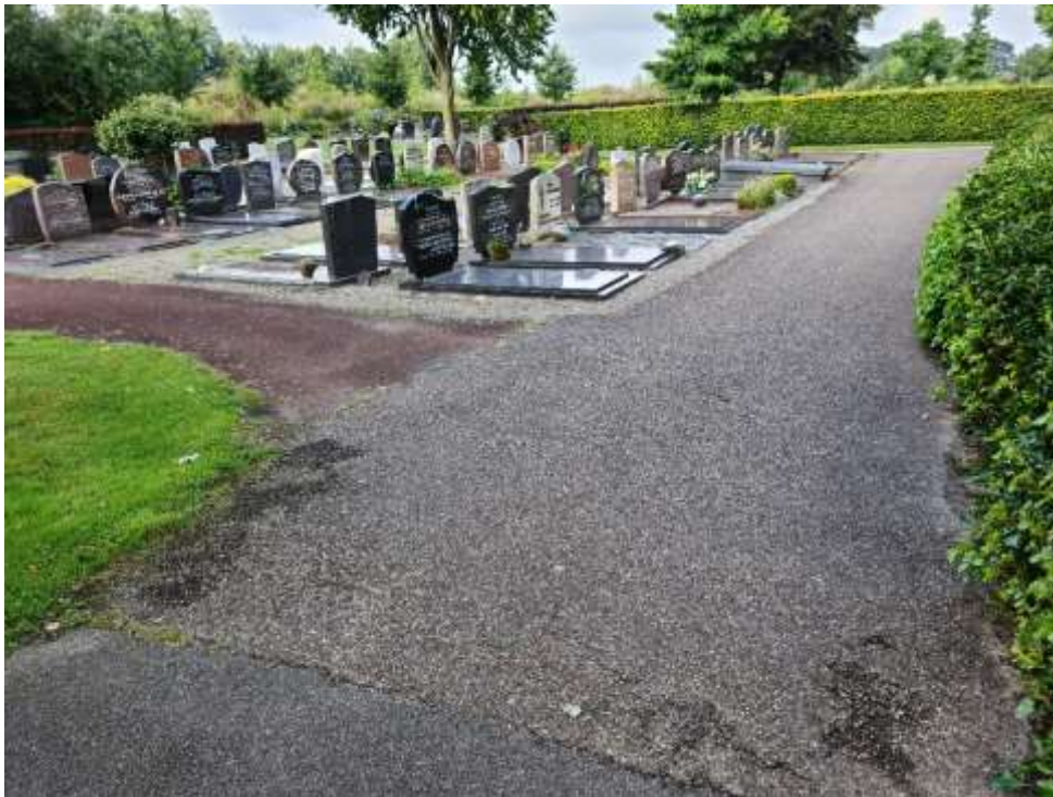
1. Padenstructuur op de begraafplaats is verouderd. Asphalt is in slechte staat. Verschillende kleuren, kwaliteit en formaat. Asphalt kan op sommige plekken ook vervangen worden door graspaden.
